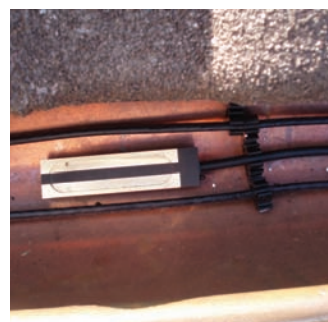
uložení vlhkostního čidla
